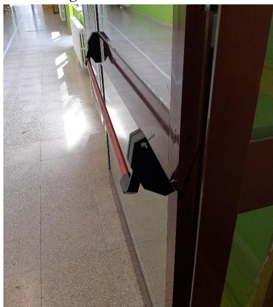
Porta di collegamento del corridoio della “zona palestra” con maniglione distaccato
