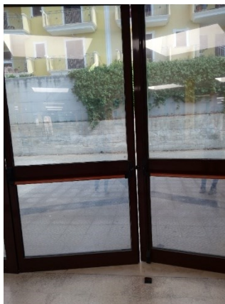
Uscita di emergenza malfunzionante
