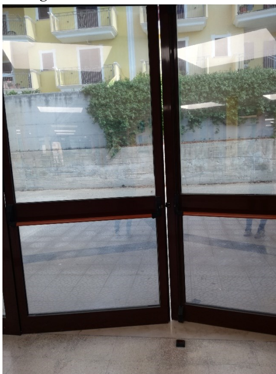
Uscita di emergenza malfunzionante
