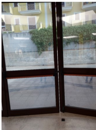
Uscita di emergenza malfunzionante
