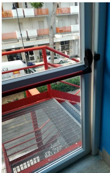
Uscita di emergenza bloccata piano primo Pad. A
