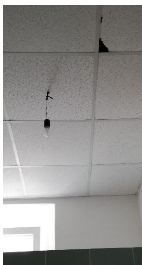
Punti Luce Servizi igienici Pad. A, pannelli controsoffitto in alcune zone danneggiati
